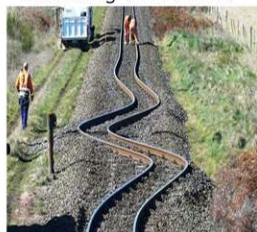
Buckling (การโก่งงอ)
